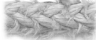
La corde doit être remplacée
